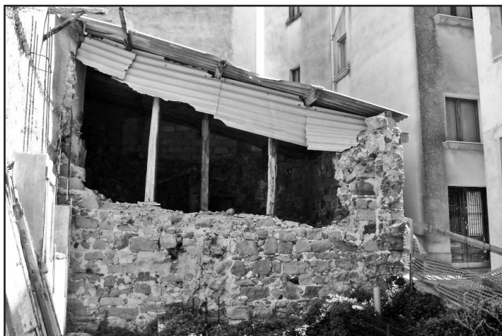
Scorci di degrado del centro storico
